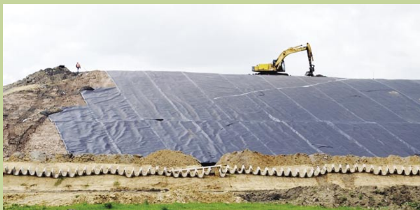
SKŁADOWISKO ODPADÓW W TARNOWSKICH GÓRACH WCIĄŻ STANOWI ZAGROŻENIE DLA LUDZI
